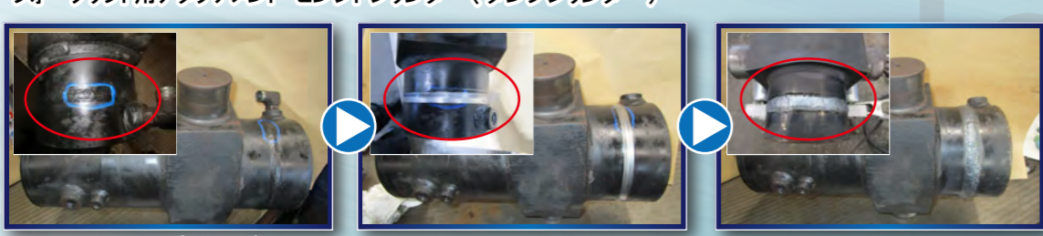
油漏れ箇所(クラック)
